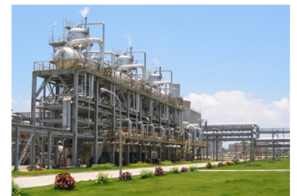
石油化工 上海氯碱化工股份有限公司 Petrochemical—Shanghai Chlor-Alkali Chemical Co., Ltd
