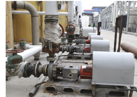
宜化集团化工流程泵应用现场（型号：ZE300-400 数量：11台套）Hubei Yihua Group Chemical process pump (Model : ZE300-400, 11 sets)
