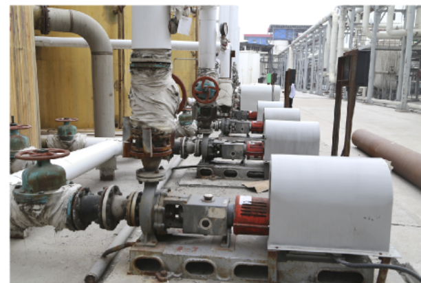
宜化集团化工流程泵应用现场（型号：ZE300-400 数量：11台套）Hubei Yihua Group Chemical process pump (Model: ZE300-400, 11 sets)
