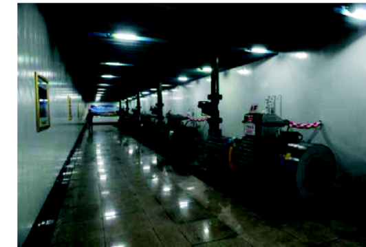
山西大同煤矿泵使用现场（型号：MD450-60×6 数量：10台）Shanxi Datong Mine Coal pump working site (Model: MD450-60×6, 10 sets)
